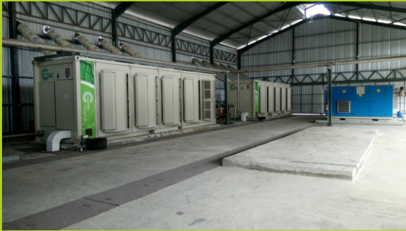
全球首座棕櫚油廢水沼氣發電廠
